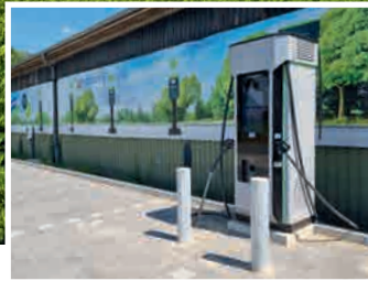
Öffentliche e-Auto Ladesäulen – mit Solarstrom von Blunk
