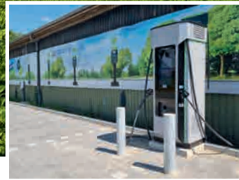
Öffentliche e-Auto Ladesäulen – mit Solarstrom von Blunk 2023
